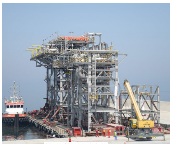
IMPIANTO MAIRE A JAKARTA
